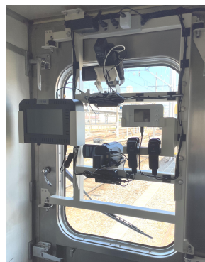
車両前面に設置されたカメラ
